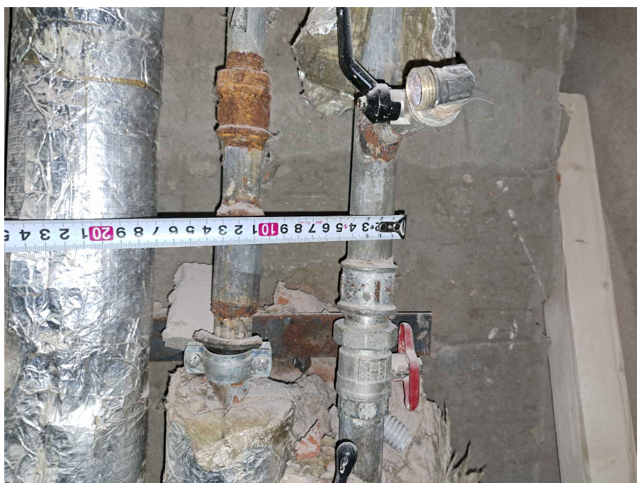
Фото 4. Стойки водоснабжения и вентиляции
